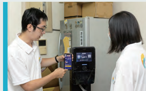
飛象開發的「需量分析預測系統」，以每 15 分鐘為單位，精準偵測不同場域的充電樁使用率、用電紀錄與金流。
